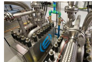
水素製造装置
